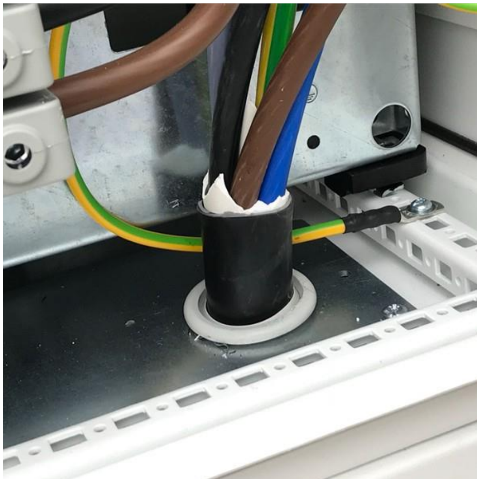
Bild 6-4 Kabeldurchführung im Schrankinnern (Öffnung für Einspeisekabel)
