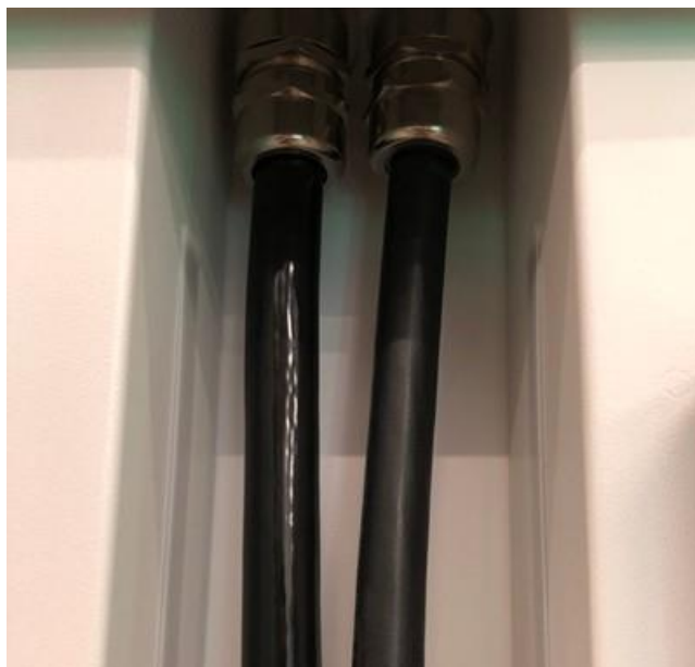
Kabelaustritte mitte und rechts (CHAdEMO & AC)
